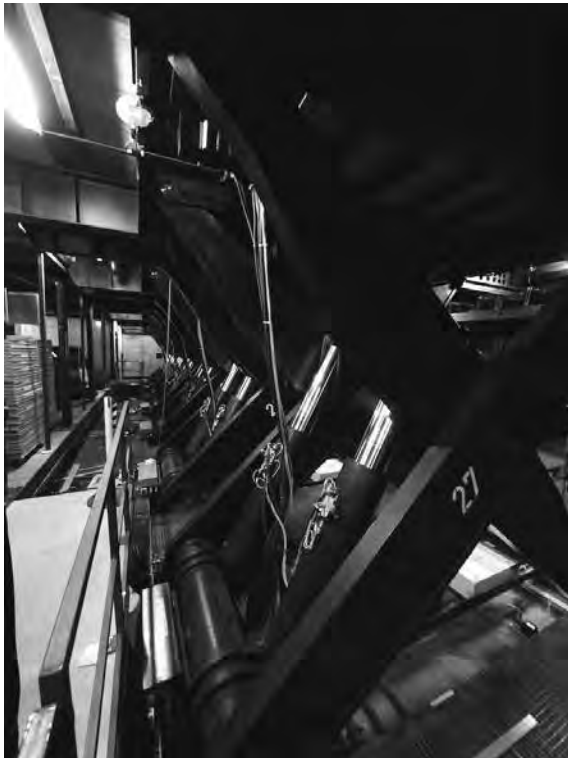
シャウビューネ劇場の床下。舞台も客席もその作品のために作り替えられる(2階席も仮設、天井も全てアクセスフリー)
