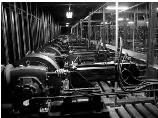
すのこ 吊り物電動モーター
