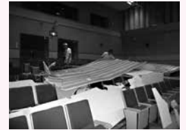
天井が落ちたホール内の様子（健軍文化ホール）
