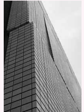
熊本県立劇場建物外壁のパネル損傷の様子。外壁全体を覆う2,000枚以上のPCパネルは1枚につき1トン以上の重量があり、落下の危険性があるので立ち入り禁止となった
