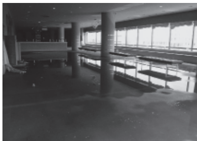
スプリンクラーヘッドの破損でホワイエも水浸しになった
