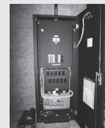
利用者ニーズに合わせ舞台電源回路を増設した
