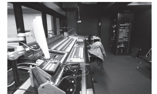
デジタル化された音響設備
