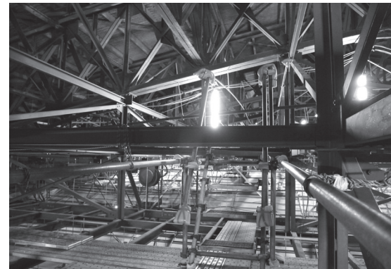
L型鋼による天井裏補強と新設されたキャットウォーク
